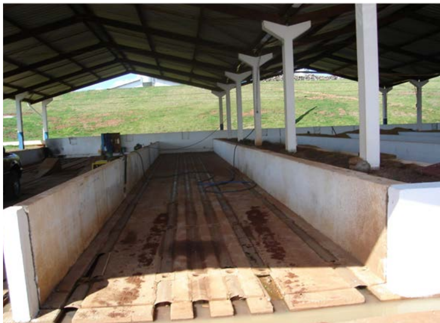
Figura 3: Decantador em tubos perfurados Fonte: Valente (2007)
